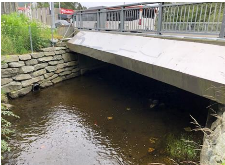
Figur 34: Utenpåhengt VA- rør langs kulvert, dagens situasjon.
